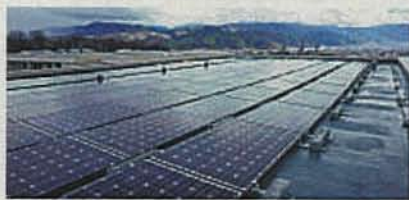
屋上に設置された太陽光パネル
