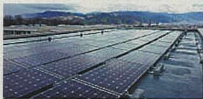
屋上に設置された太陽光パネル
